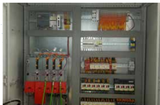
Schaltschrank mit PLC-Steuerung und SERVO-Frequenzumrichtern.
